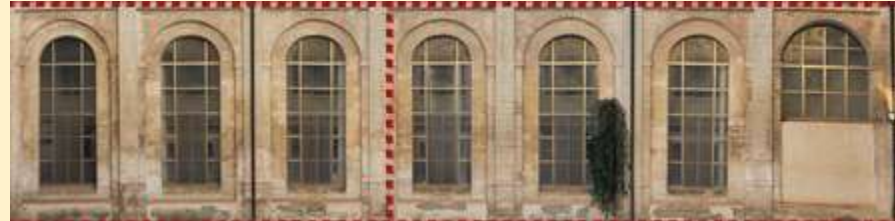
Mappatura del degrado sul prospetto Sud del Chiostro
